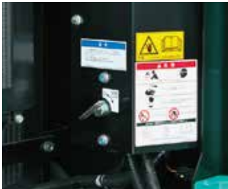
バッテリー遮断スイッチ
